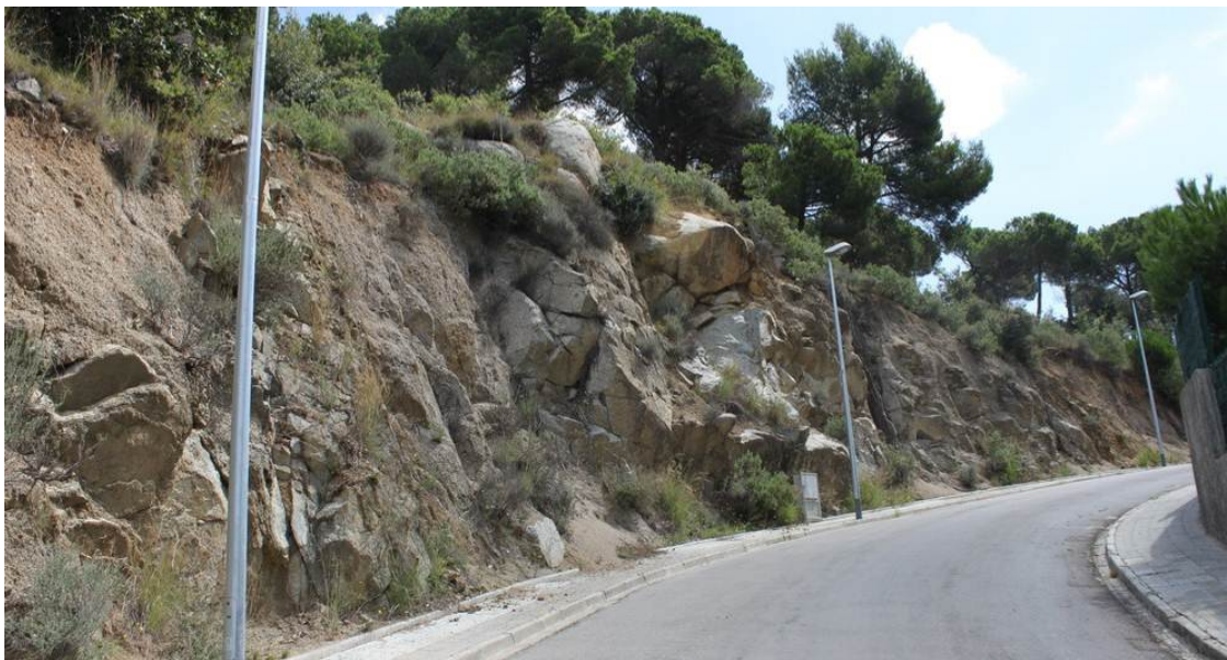
Fotografia 21. Part del talús inestable a l'avinguda de Sant Mateu
