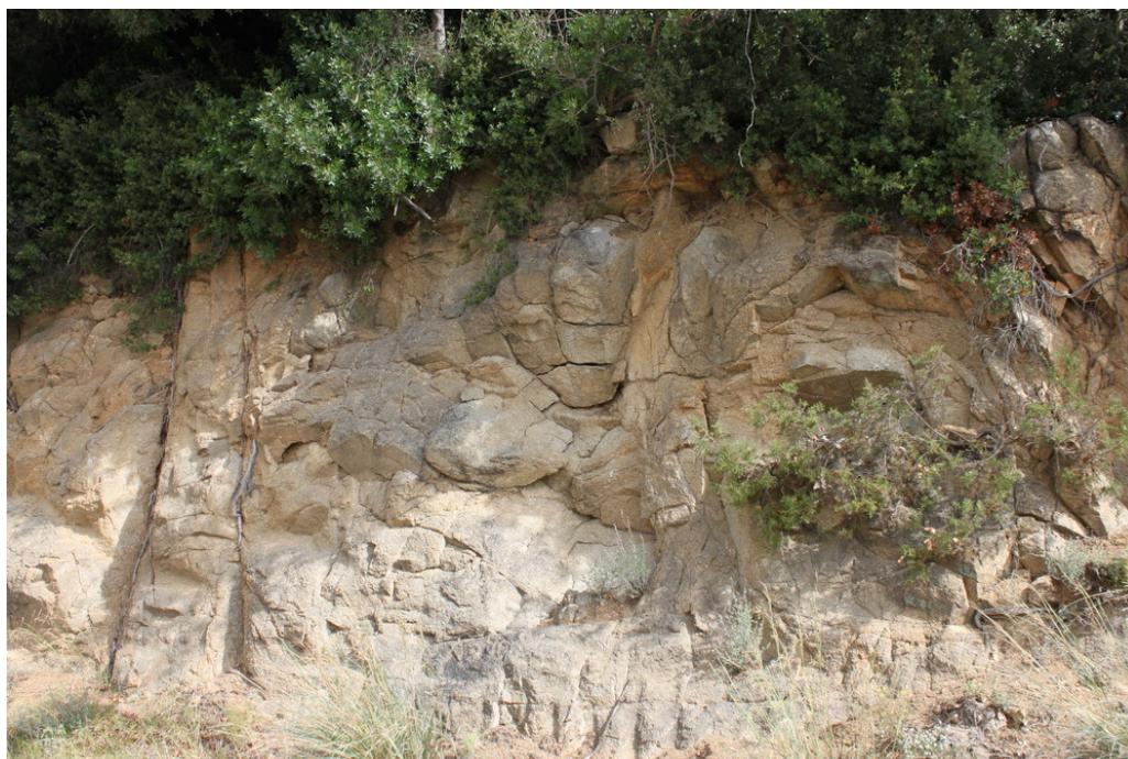
Fotografia 15. Detall del talús del carrer Salvador Espriu.
