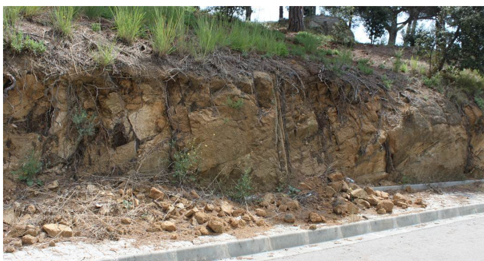
Fotografia 20. Talús inestable de sauló al carrer de Mulassa de Can Magarola
