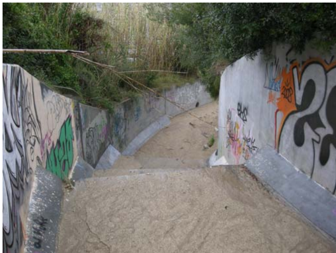
Foto 2. Vista de la obra de caiguda fins el caláís paral·lel a l'autopista
