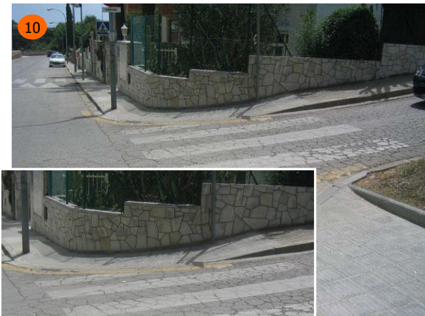
10 Mal estat del paviment i marques viàries. El rebaix de la vorera genera problemes de mobilitat per la inestabilitat de cadires de rodes i la superfície en pendent que és molt gran.
