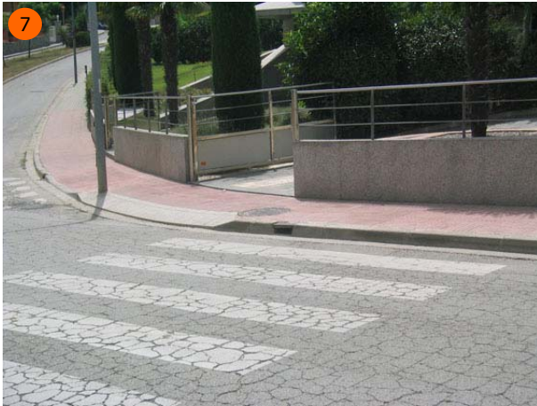
7 Gual per a sortida de vehicles i pas de vianants sense adaptar. Modes de desplaçament amb avantatges respecte altres.
