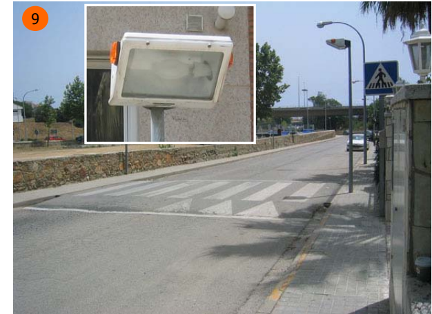
9 Irregularitats al paviment fan que els vehicles colpegin amb els baixos sortint de la plataforma. El pas està il·luminat.
