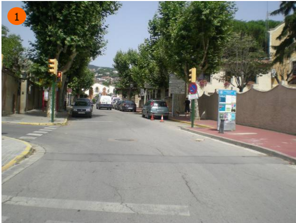
Carrer Riera Fosca, vista de la secció general. S'observa la manca de pintura entre carrils.
