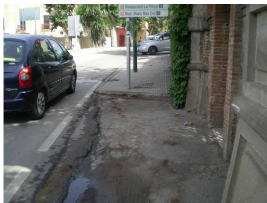
Imatge 23. BP5002 amb carrer Ferran Fabra. Un tram de la vorera està sense pavimentar.
