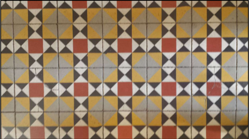
FOTO 5 REBEDOR PAVIMENT HIDRÀULIC
