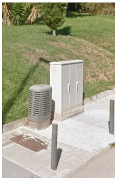
Quadre de control AC
